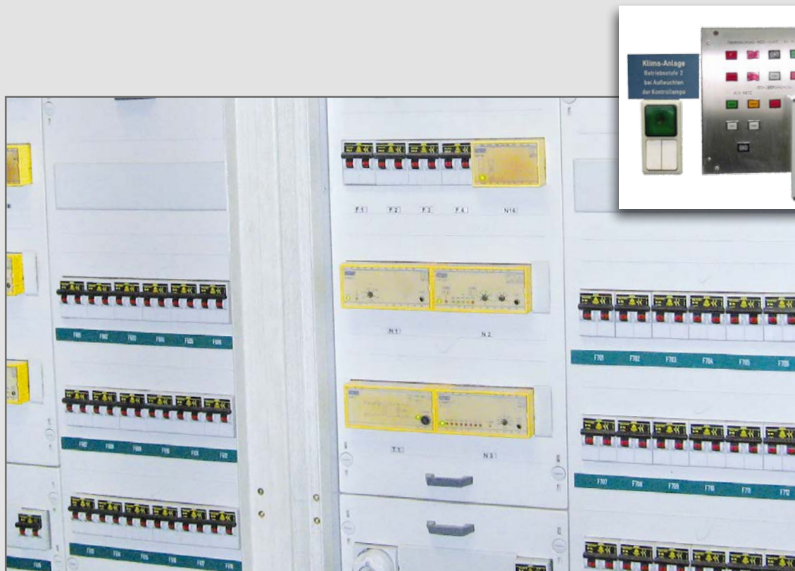
Ältere Anlagen sind nicht in der Lage, moderne medizinisch-elektrische Geräte zu überwachen!
