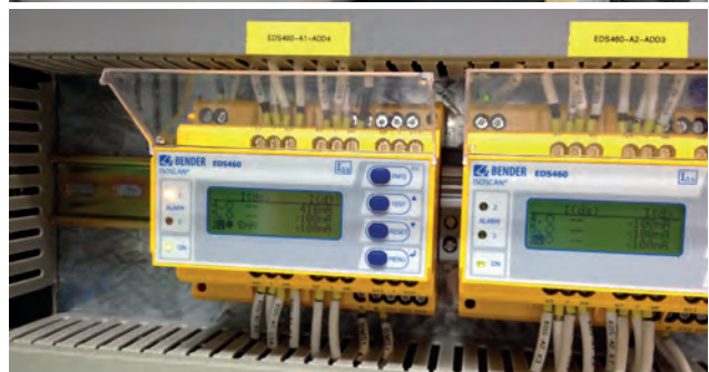
MES-Engineering mit Lösungen von Bender im PVD-Bohrinsel-Projekt
