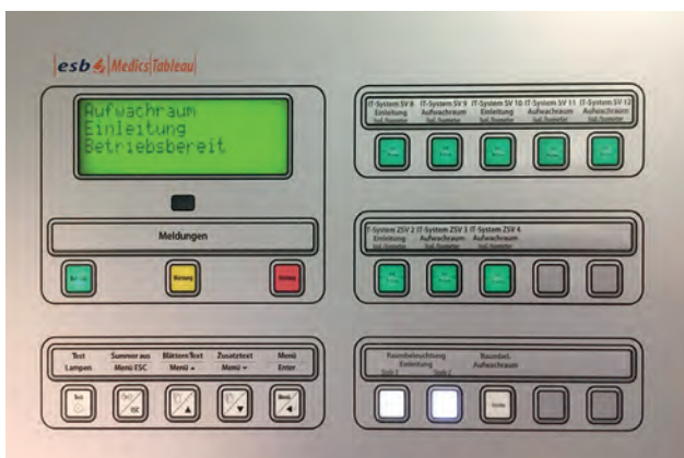
Stand 2004: TM1000 mit Überwachung von acht IT-Systemen und Steuerung der Lichtgruppen
