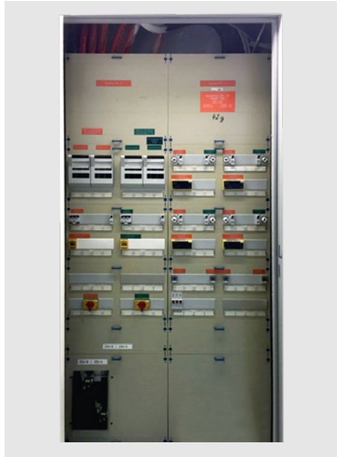
Détail d'une installation ancienne
