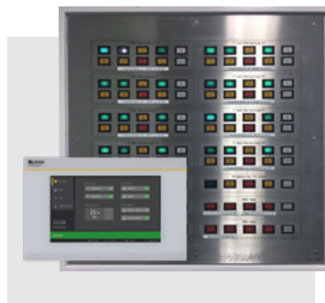
Détail d'une installation ancienne et nouvelle
